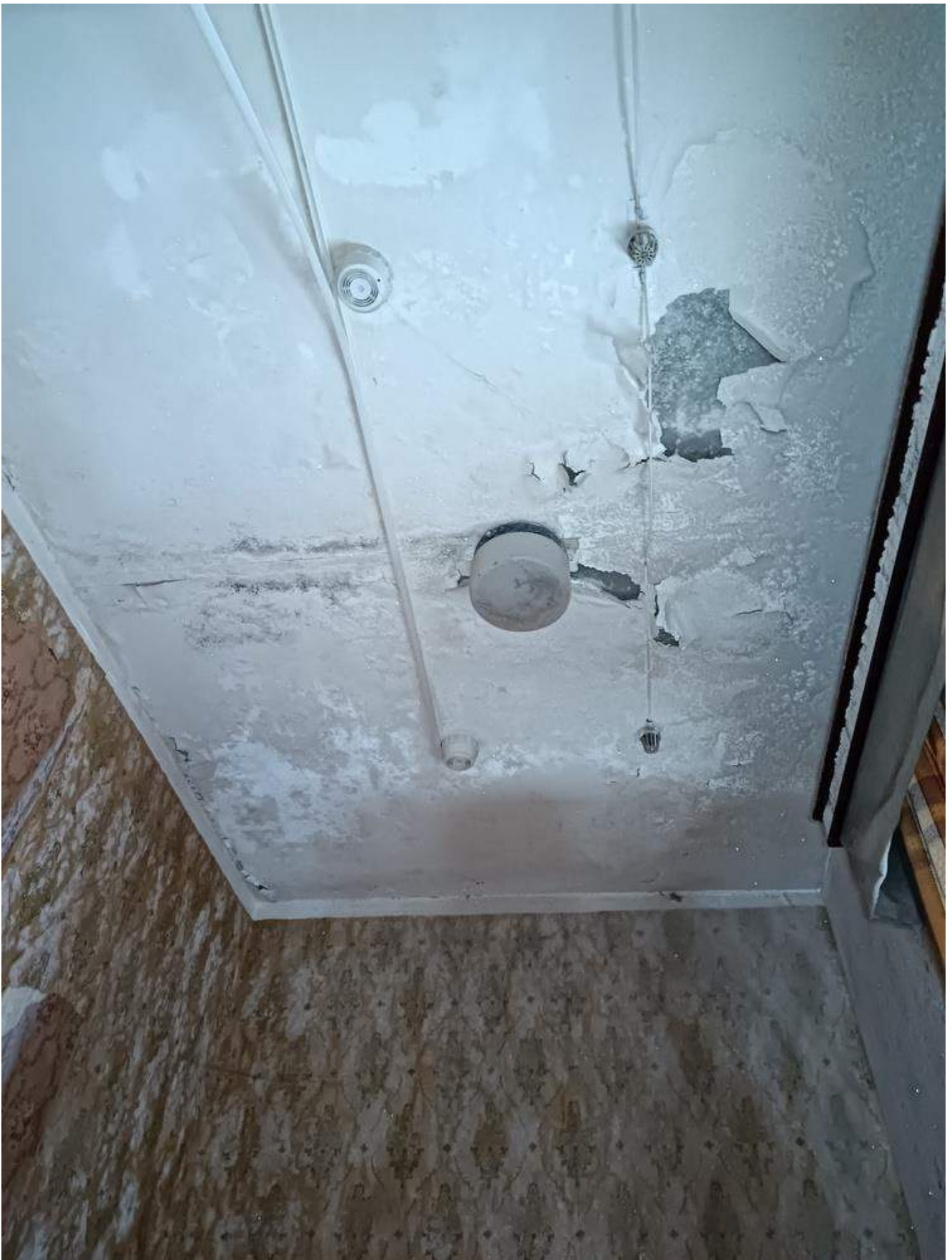
Фото 2.10 Состояние внутренних электрических сетей и освещения. Пожарно-дымовые извещатели. Административный корпус
