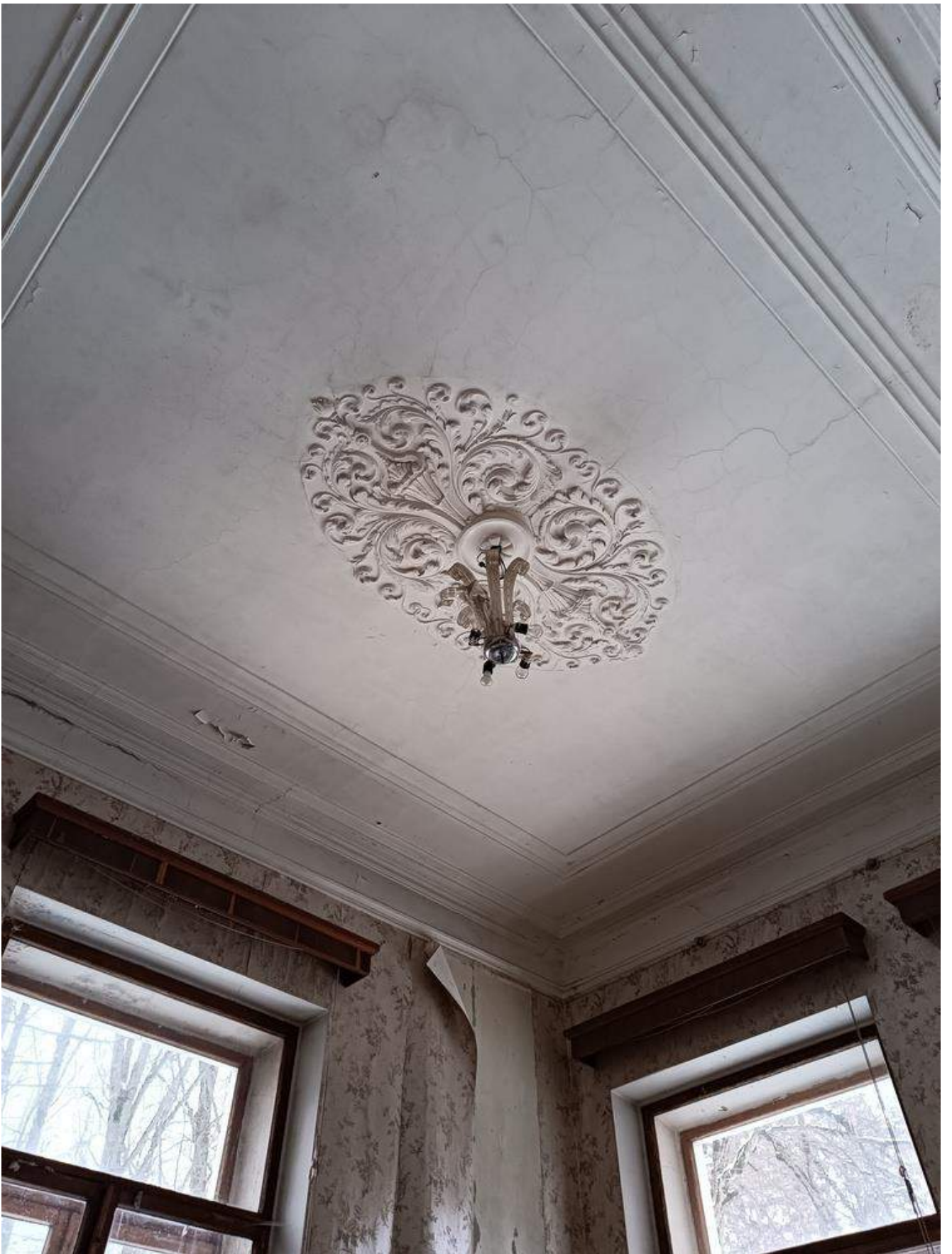
Фото 2.18 Состояние приборов освещения. Основное здание
