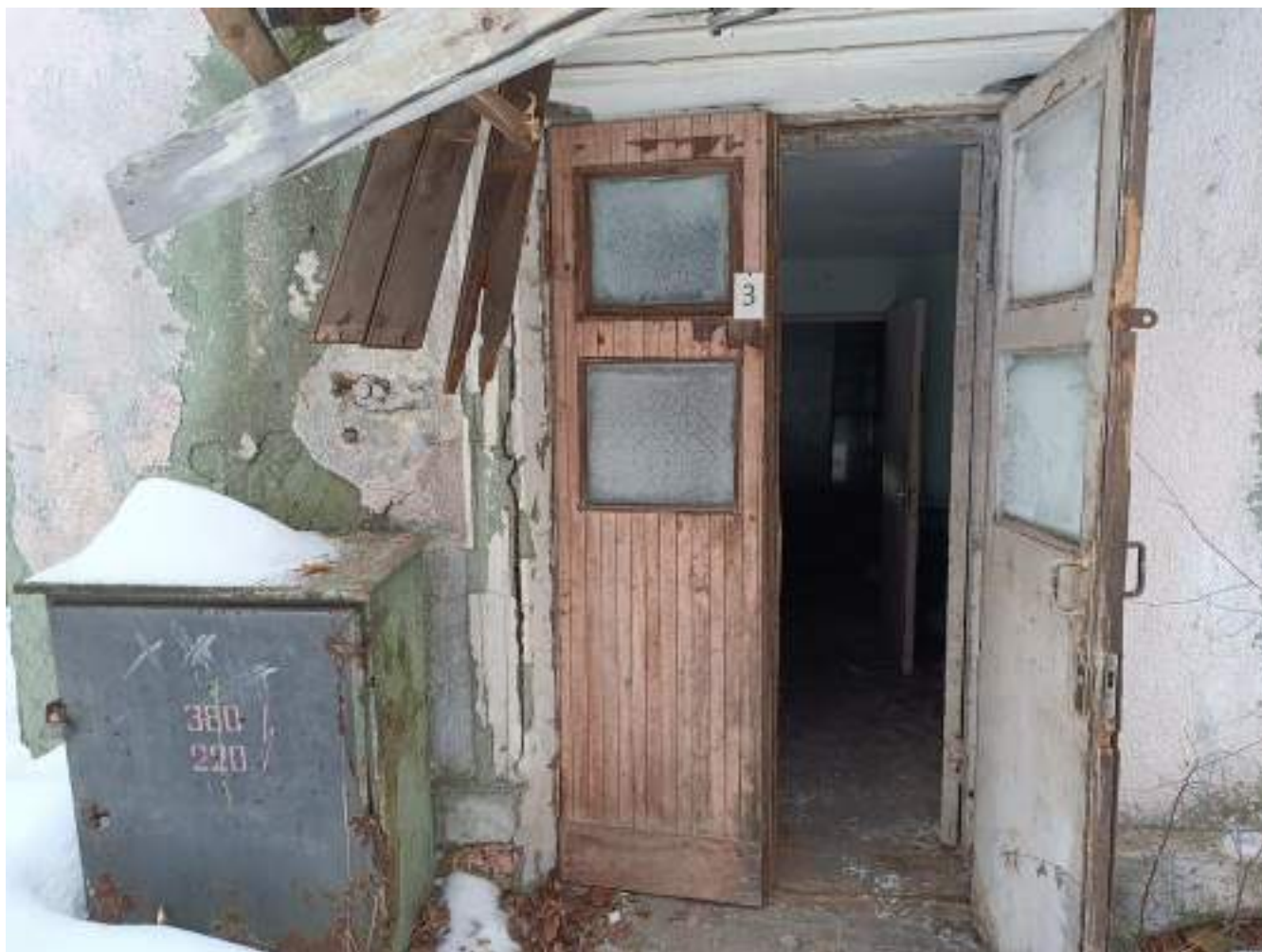
Фото 2.1 Электрощитовая. Административный корпус
