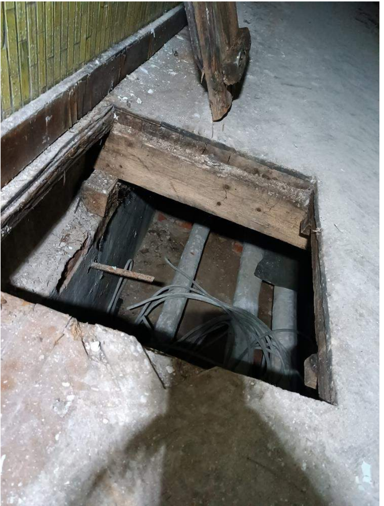
Фото 4.25 Состояние трубопроводов системы водоснабжения. Бассейн
