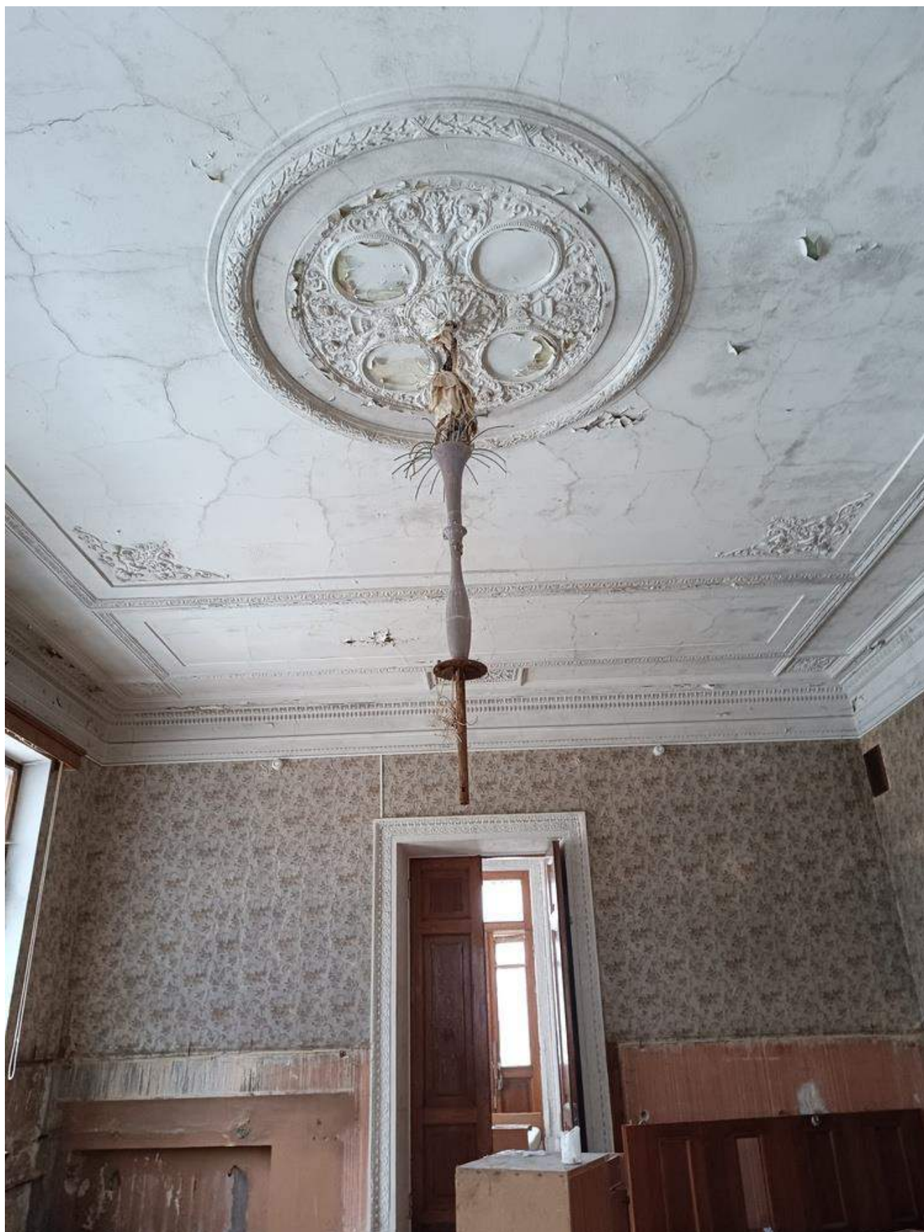
Фото 2.20 Состояние приборов освещения. Основное здание
