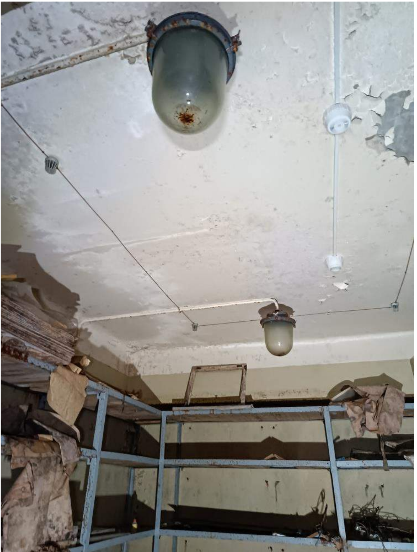
Фото 2.14 Состояние внутренних электрических сетей и освещения. Пожарно-дымовые извещатели. Основное здание
