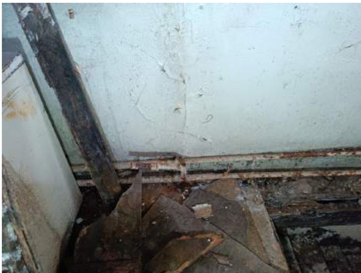
Фото 3.16 Состояние трубопроводов системы отопления. Демонтаж. Административный корпус
