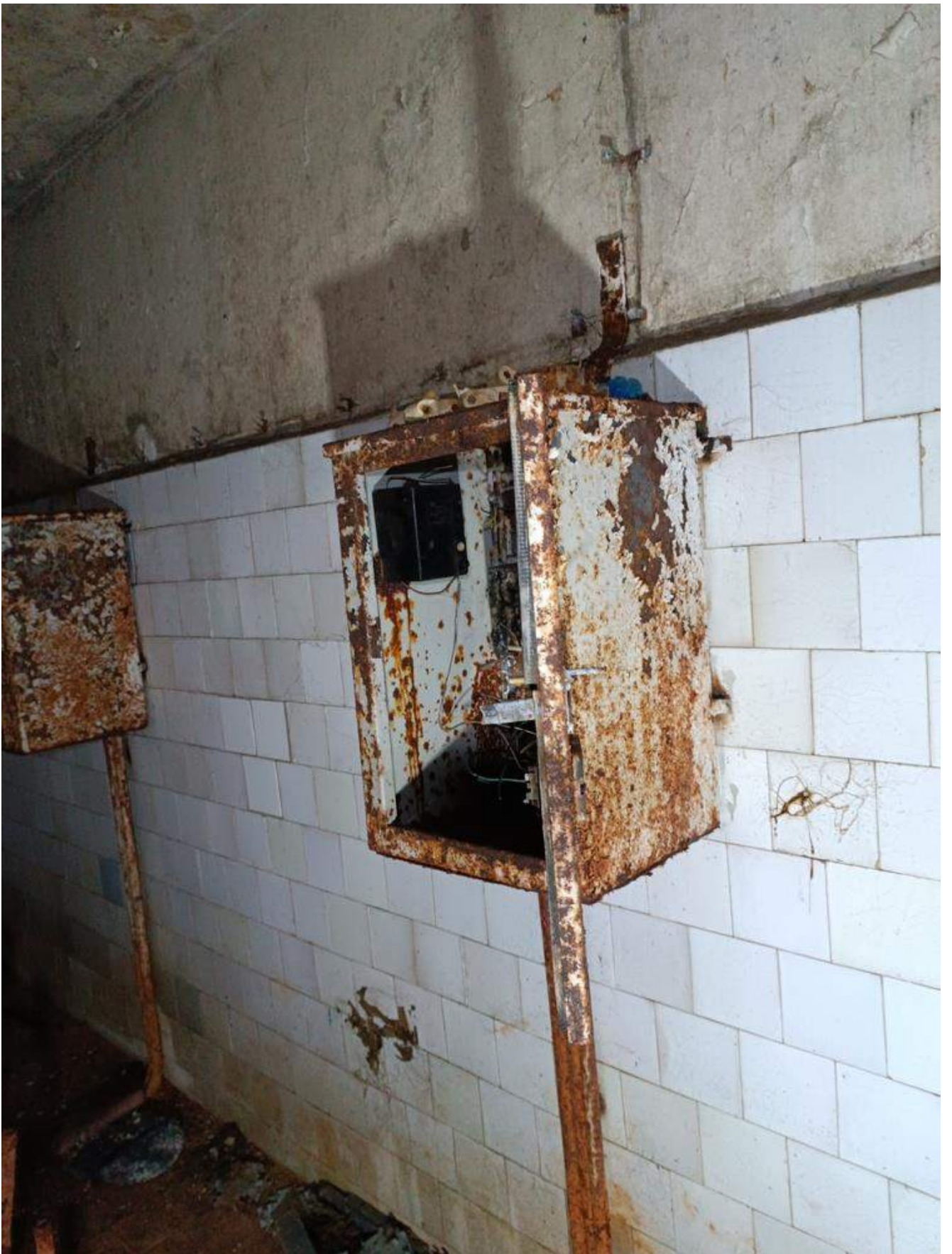
Фото 2.31 Щит управления внутренних электрических сетей. Демонтаж. Бомбоубежище
