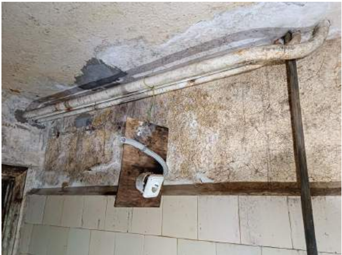
Фото 3.31 Состояние трубопроводов системы отопления. Бомбоубежище
