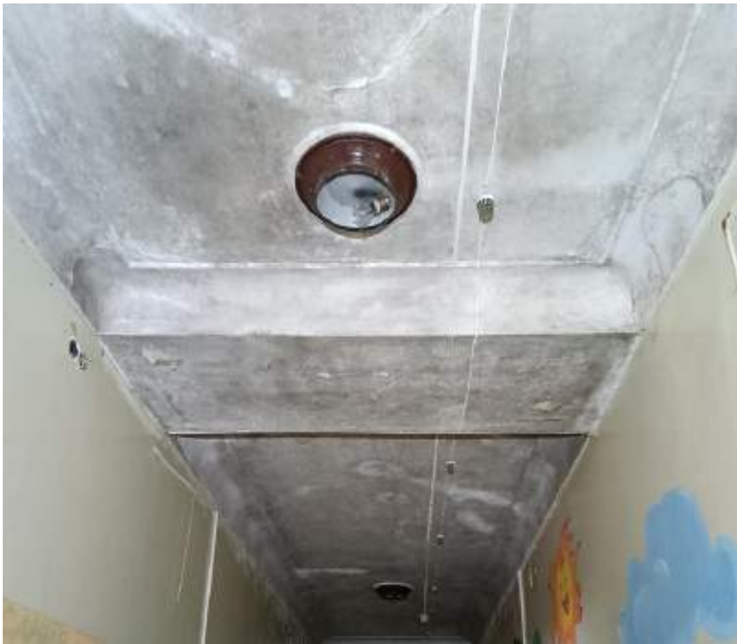
Фото 2.3 Состояние внутренних электрических сетей и освещения. Административный корпус
