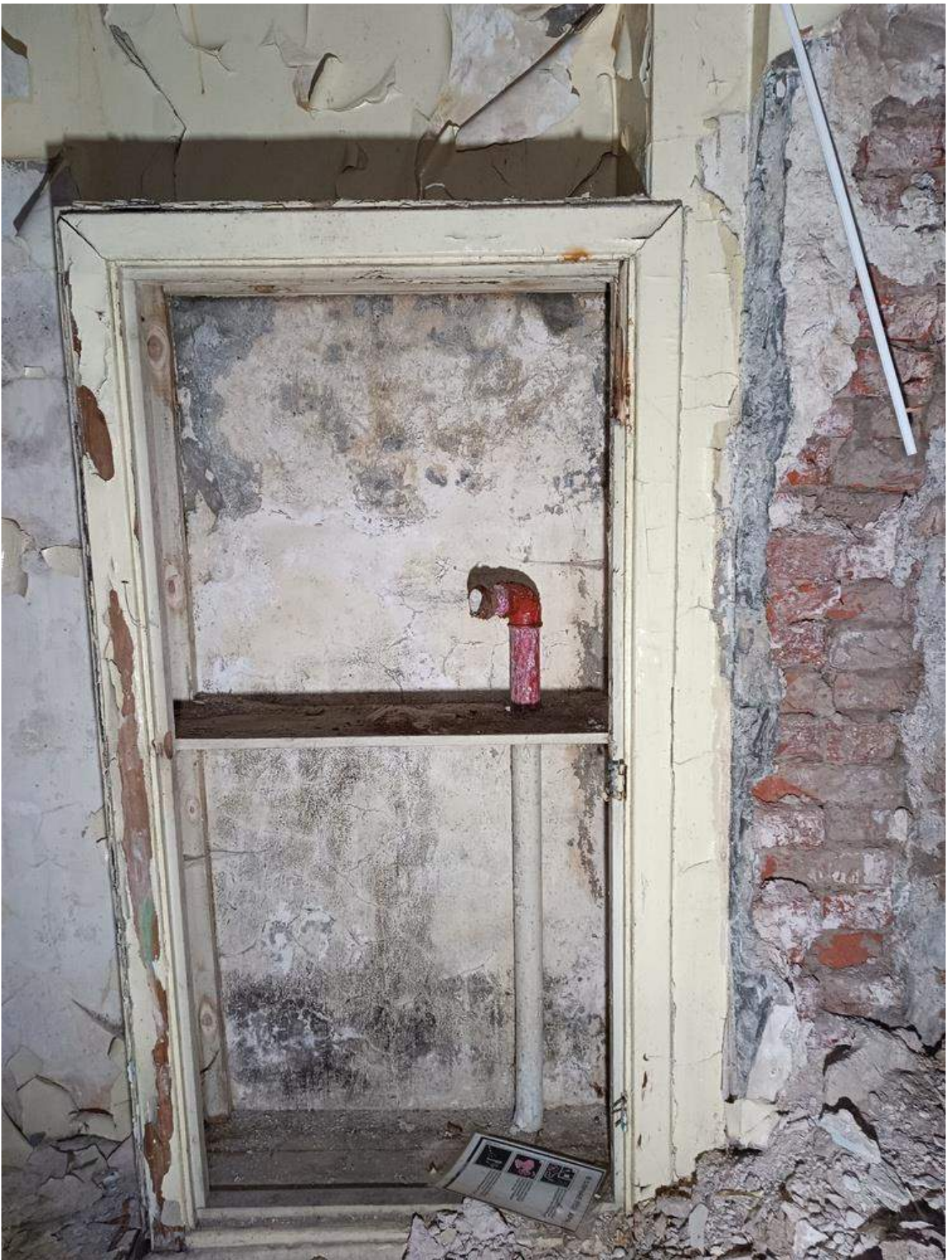
Фото 4.13 Водопровод на пожаротушение. Основное здание
