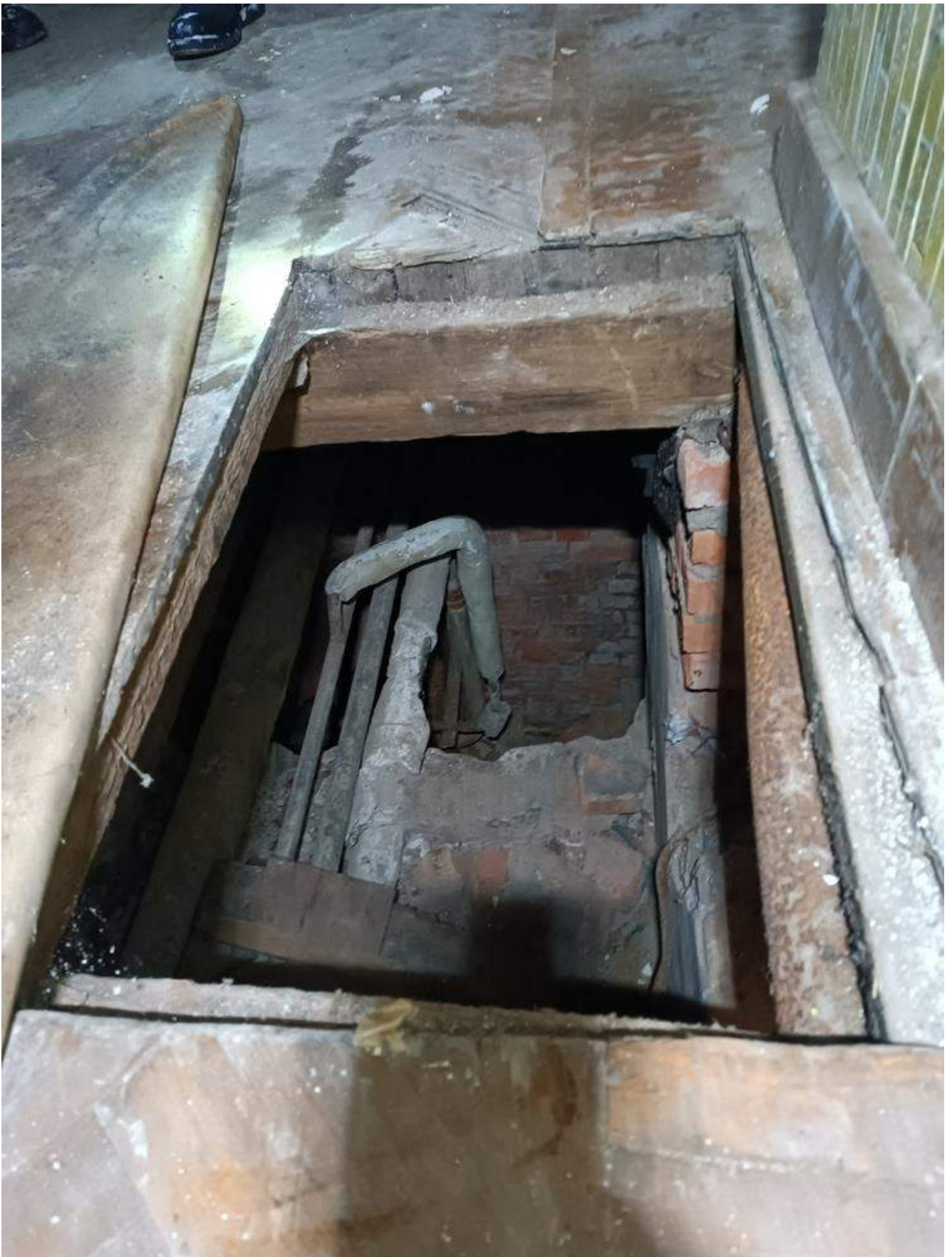
Фото 4.3 Состояние трубопроводов систем водоснабжения и водоотведения. Административный корпус
