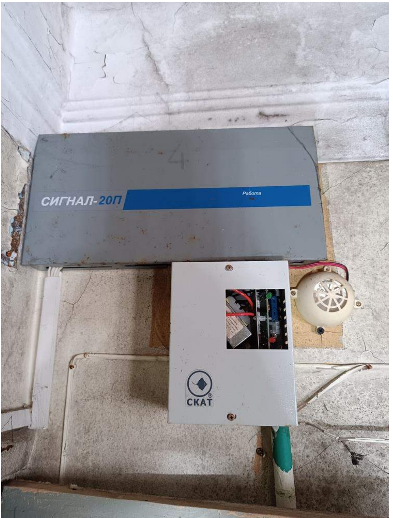
Фото 2.22 Приборы приемно-контрольные охранно-пожарные. Основное здание
