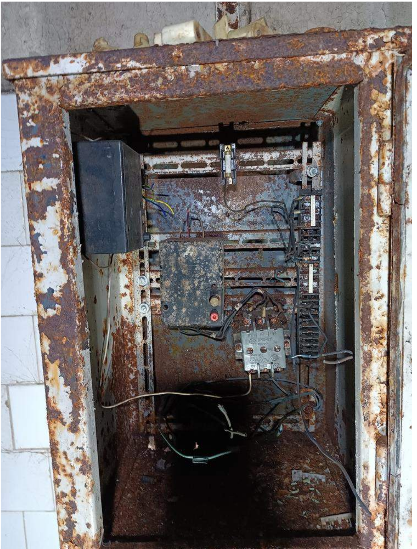
Фото 2.32 Щит управления внутренних электрических сетей. Демонтаж. Бомбоубежище
