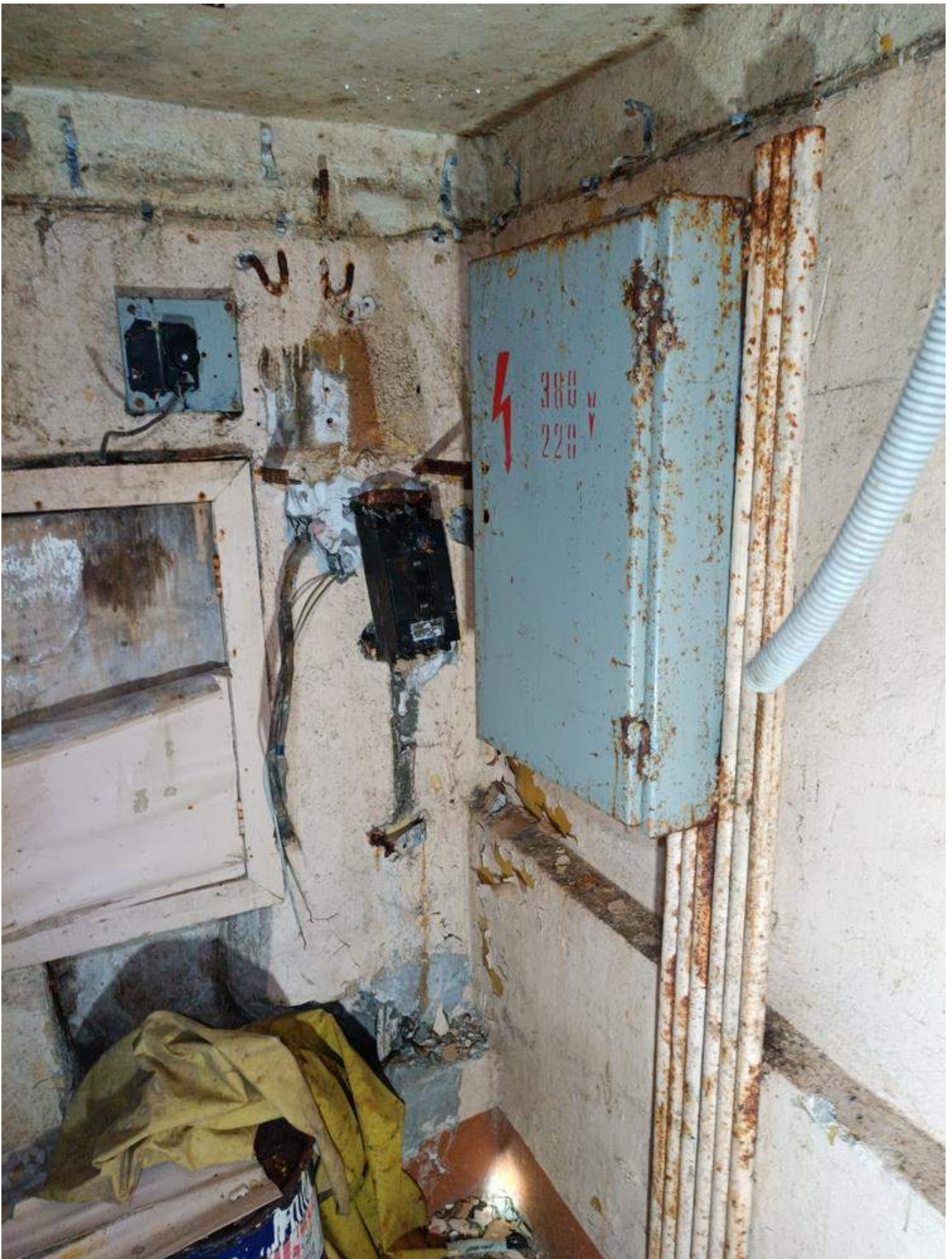
Фото 2.28 Щит управления и состояние внутренних электрических сетей. Демонтаж. Бомбоубежище
