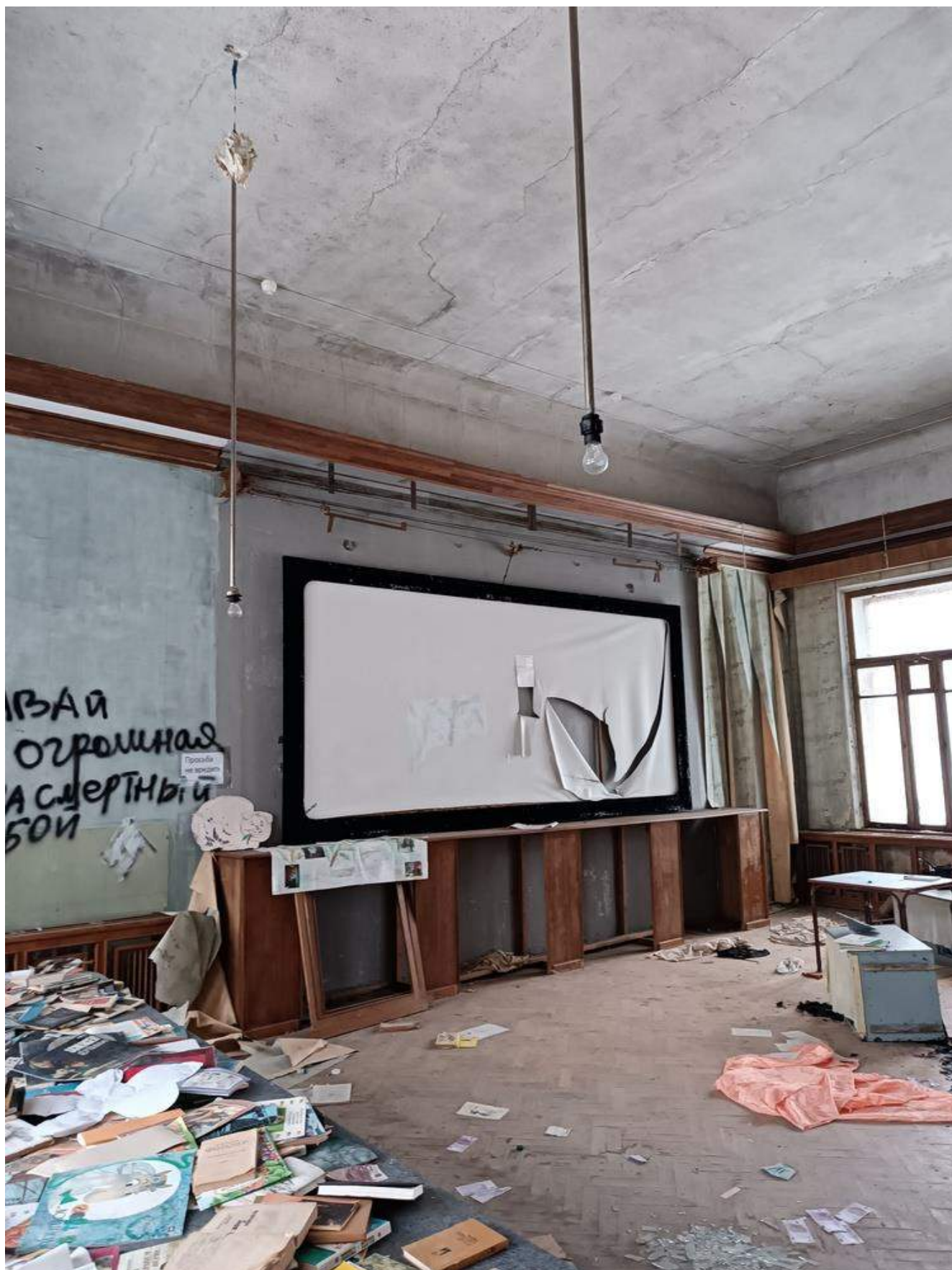
Фото 2.23 Состояние приборов освещения. Основное здание
