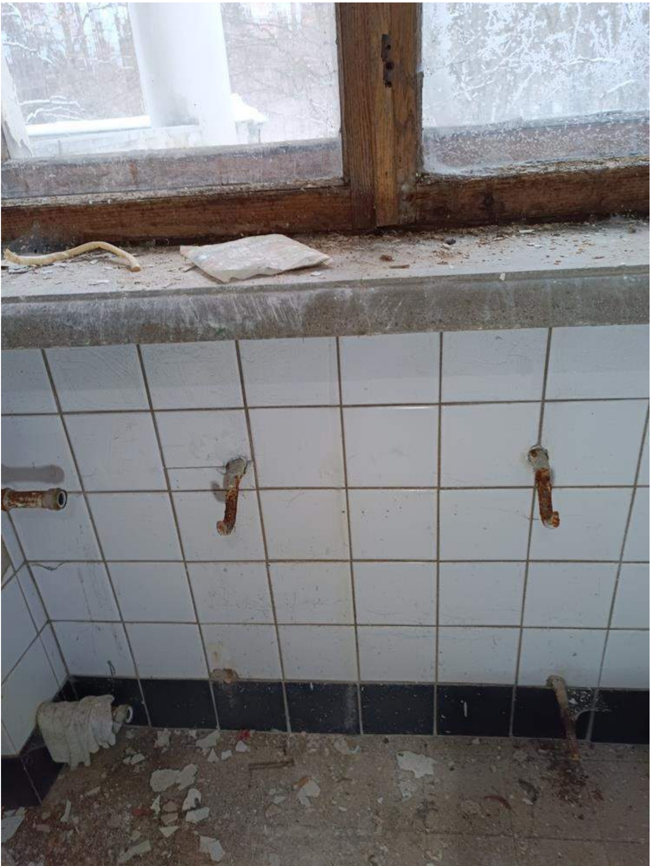
Фото 3.23 Состояние системы отопления. Демонтаж радиаторов отопления. Основное здание
