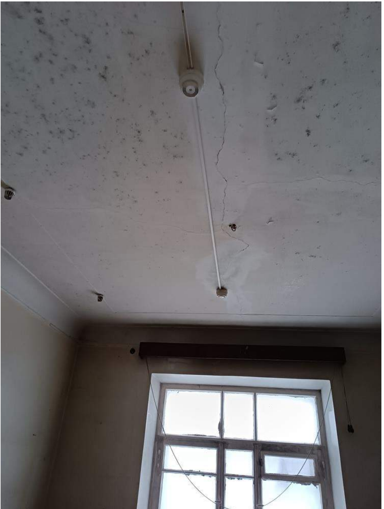
Фото 2.2 Состояние внутренних электрических сетей и освещения. Пожарно-дымовые извещатели. Административный корпус
