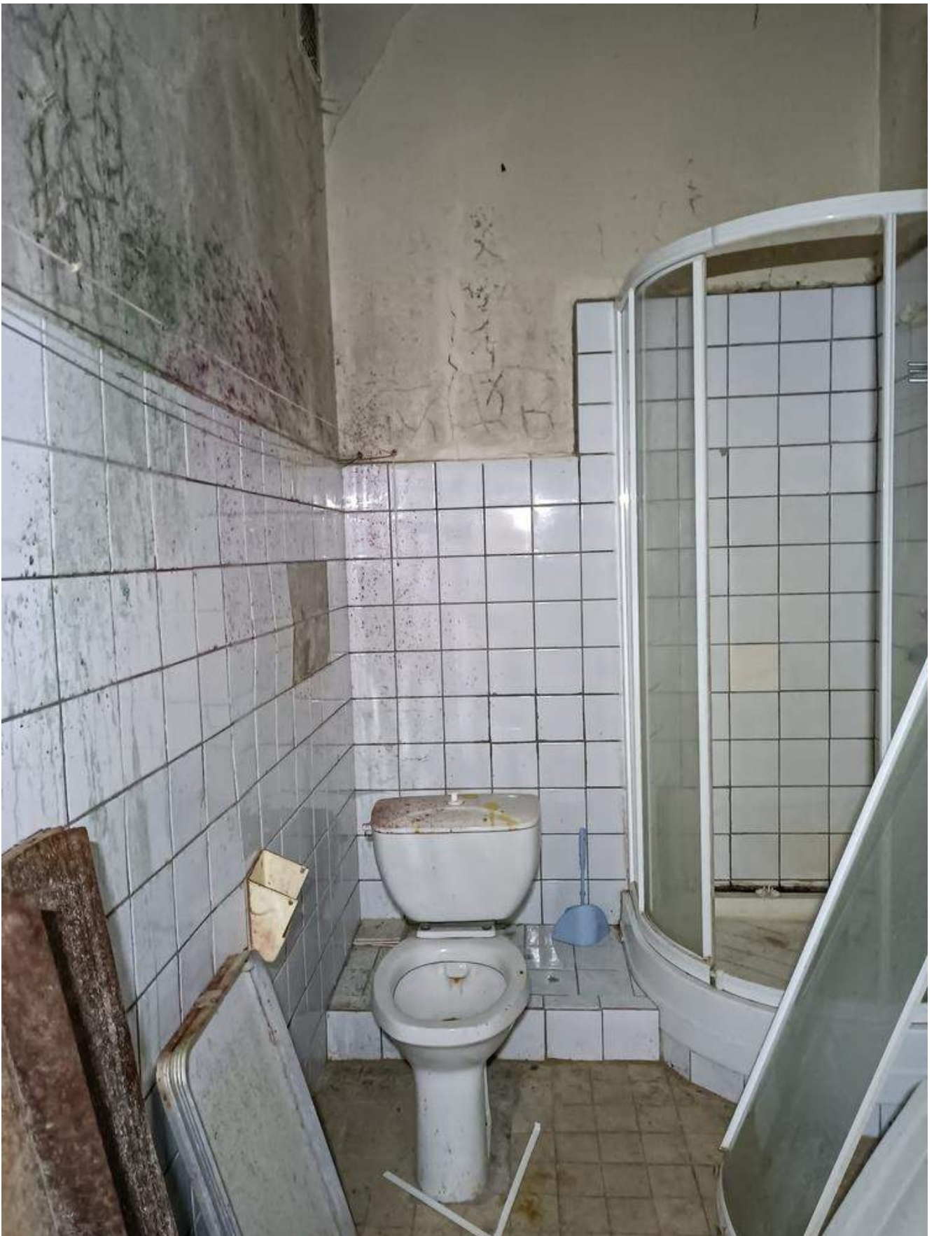
Фото 4.4 Состояние санитарно-технического узла. Административный корпус
