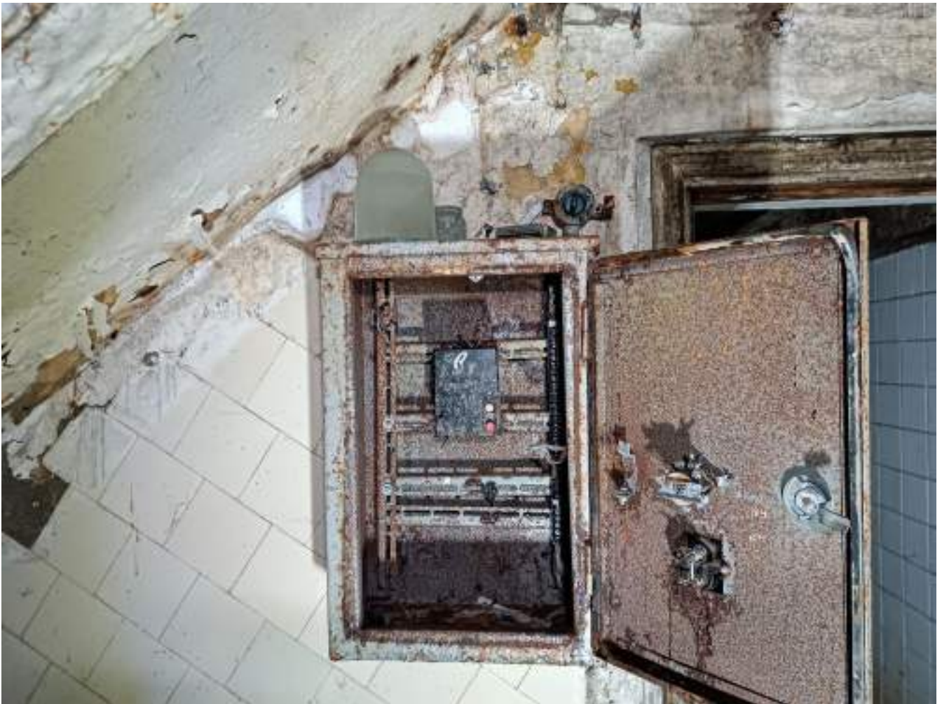
Фото 2.30 Щит управления внутренних электрических сетей. Демонтаж. Бомбоубежище
