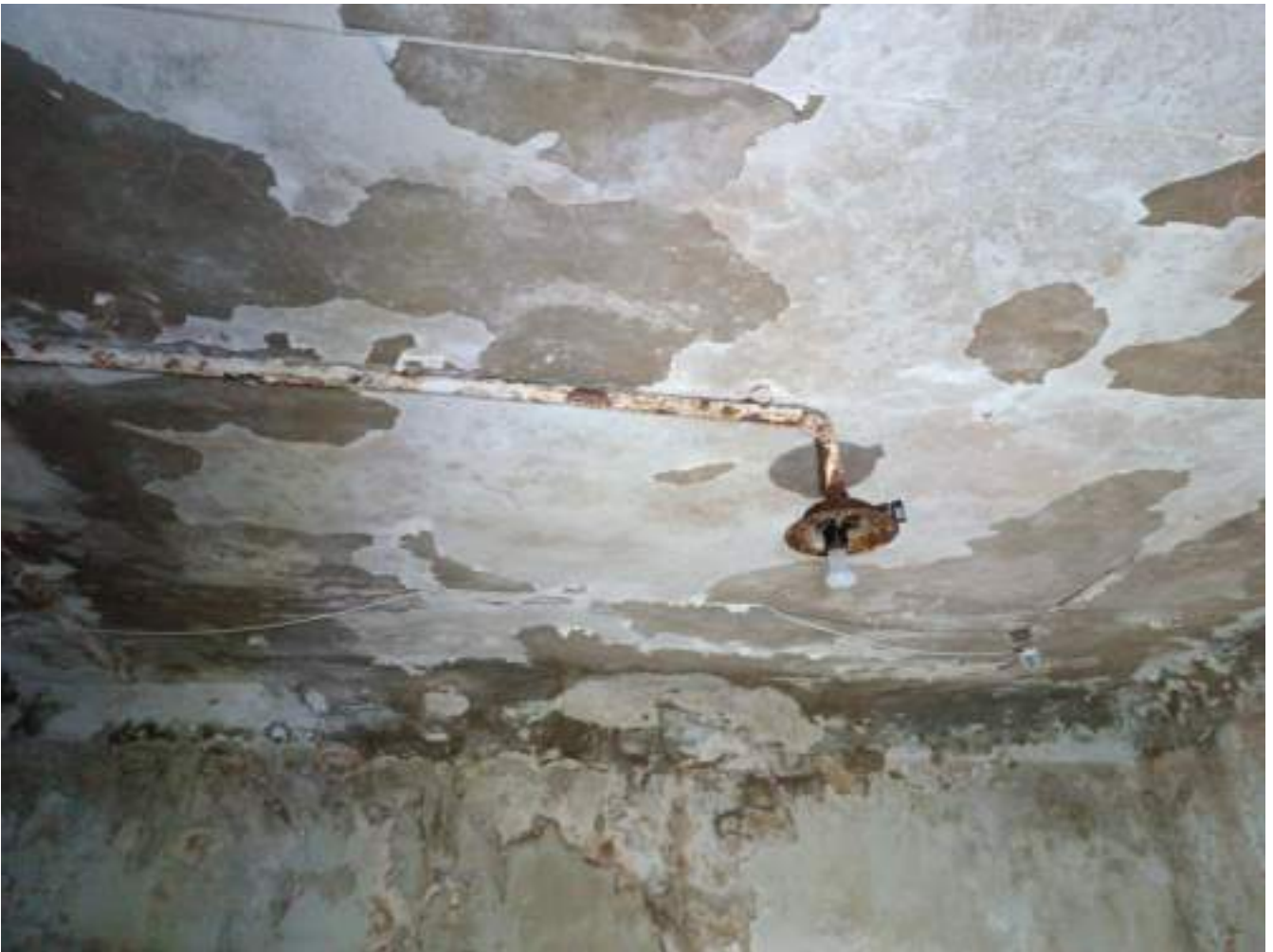
Фото 2.17 Состояние внутренних электрических сетей и освещения. Основное здание
