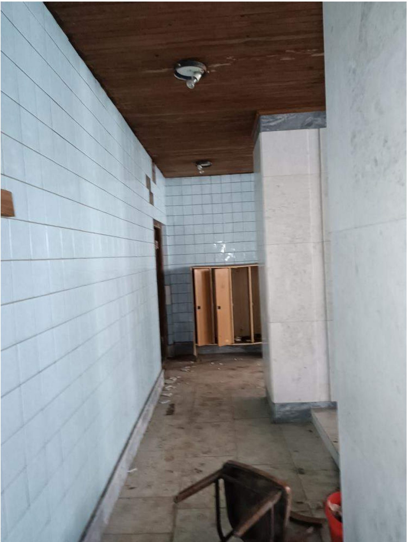
Фото 2.24 Состояние приборов освещения. Бассейн
